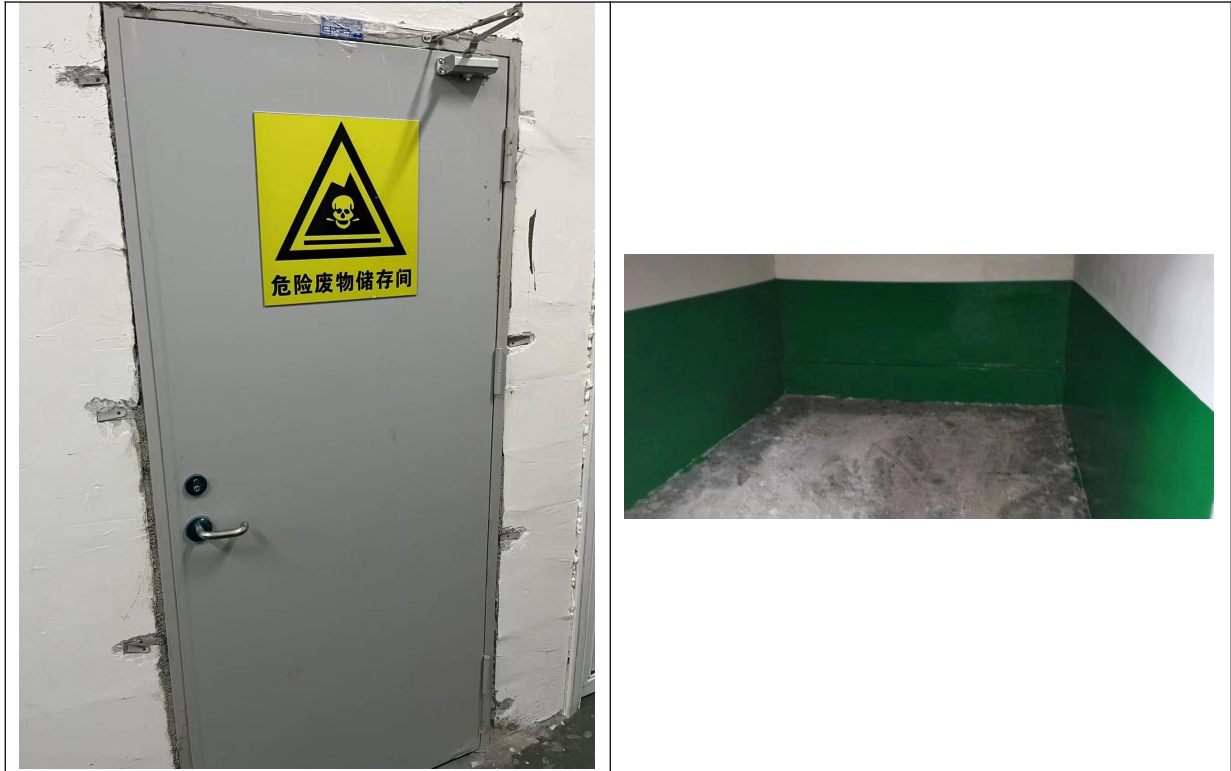
图 3-3 项目危废间图片
